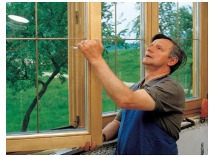
Das Einsetzen neuer Fenster ist eine einfache Maßnahme, die innerhalb eines Tages zu erledigen ist.
